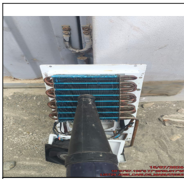
FOTO LIMPIEZA Y ESTADO DE SERPENTIN DE UC
