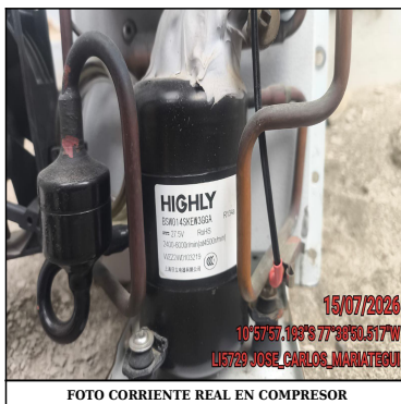
FOTO CORRIENTE REAL EN COMPRESOR
