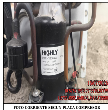
FOTO CORRIENTE SEGUN PLACA COMPRESOR
