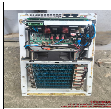
FOTO COMPONENTES DE UC (PARTE ELECTRICA)
