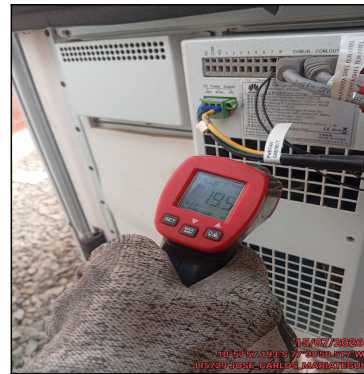
FOTO TEMPERATURA DE EXPULSION
