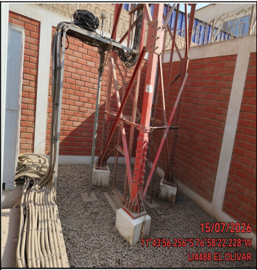
Foto Panorámica del Interior del Site
