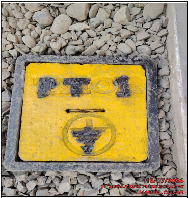
Pozo a tierra
