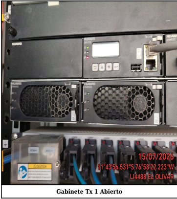
Gabinete Tx 1 Abierto
