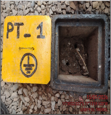
Pozo a tierra
