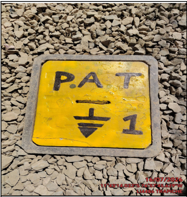
Pozo a tierra
