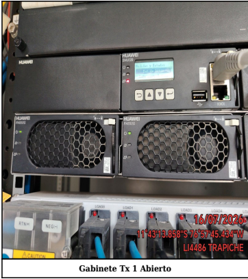
Gabinete Tx 1 Abierto
