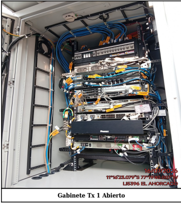
Gabinete Tx 1 Abierto
