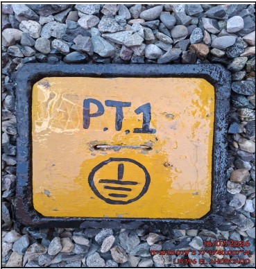
Pozo a tierra
