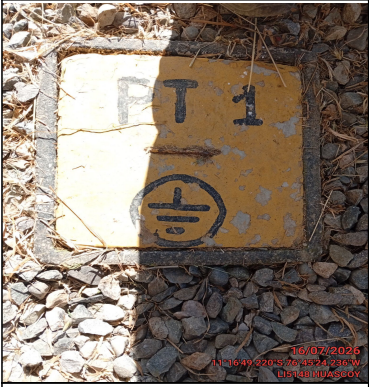
Pozo a tierra
