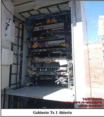
Gabinete Tx 1 Abierto
