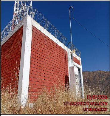
Pozo a tierra
