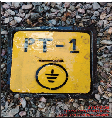
Pozo a tierra
