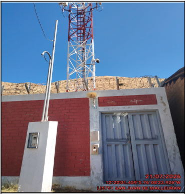
Pozo a tierra
