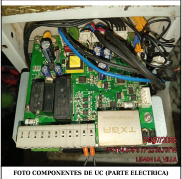
FOTO COMPONENTES DE UC (PARTE ELECTRICA)
