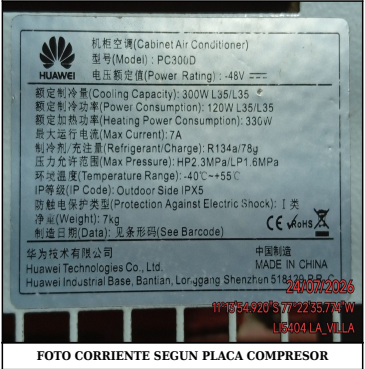
FOTO CORRIENTE SEGUN PLACA COMPRESOR
