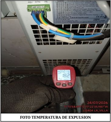
FOTO TEMPERATURA DE EXPULSION
