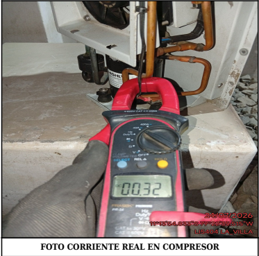
FOTO CORRIENTE REAL EN COMPRESOR
