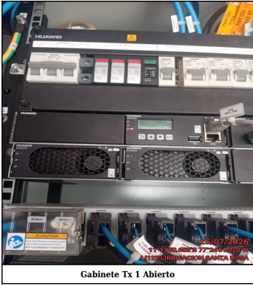
Gabinete Tx 1 Abierto
