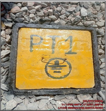
Pozo a tierra
