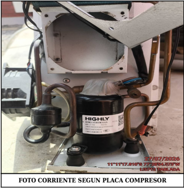
FOTO CORRIENTE SEGUN PLACA COMPRESOR
