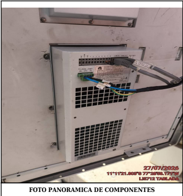
FOTO PANORAMICA DE COMPONENTES
