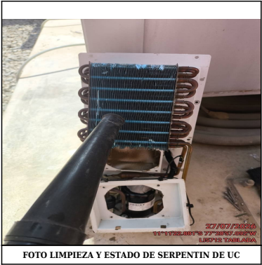
FOTO LIMPIEZA Y ESTADO DE SERPENTIN DE UC
