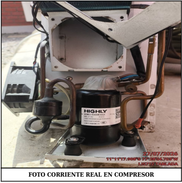
FOTO CORRIENTE REAL EN COMPRESOR
