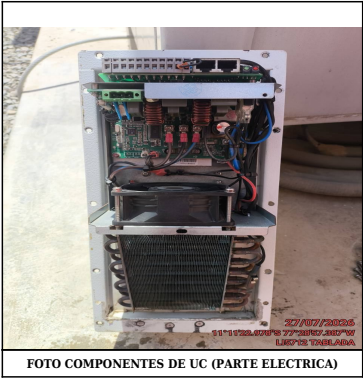
FOTO COMPONENTES DE UC (PARTE ELECTRICA)
