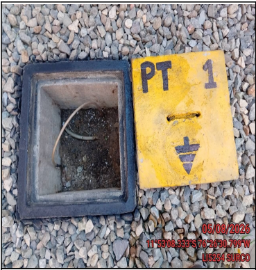
Pozo a tierra
