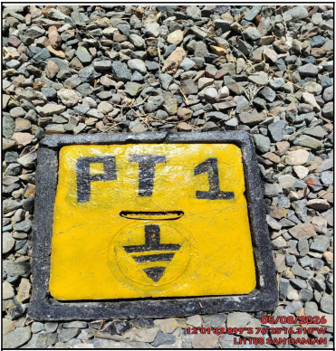
Pozo a tierra
