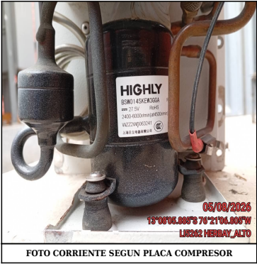
FOTO CORRIENTE SEGUN PLACA COMPRESOR
