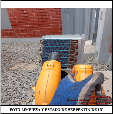
FOTO LIMPIEZA Y ESTADO DE SERPENTIN DE UC
