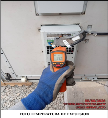
FOTO TEMPERATURA DE EXPULSION
