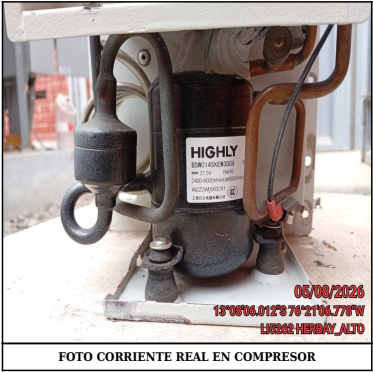
FOTO CORRIENTE REAL EN COMPRESOR
