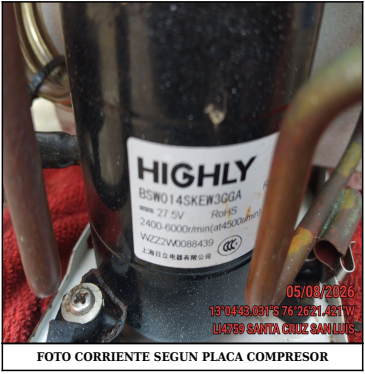
FOTO CORRIENTE SEGUN PLACA COMPRESOR
