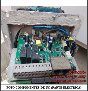
FOTO COMPONENTES DE UC (PARTE ELECTRICA)
