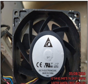
FOTO CORRIENTE SEGUN PLACA EN MOTOR VENTILADOR
