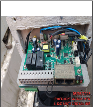
FOTO DE COMPONENTES DE UE (PARTE ELECTRICA)
