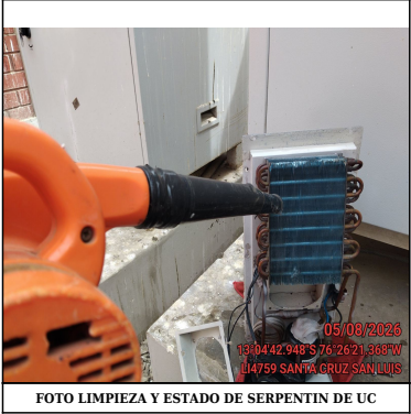
FOTO LIMPIEZA Y ESTADO DE SERPENTIN DE UC
