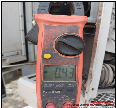
FOTO CORRIENTE REAL EN MOTOR VENTILADOR
