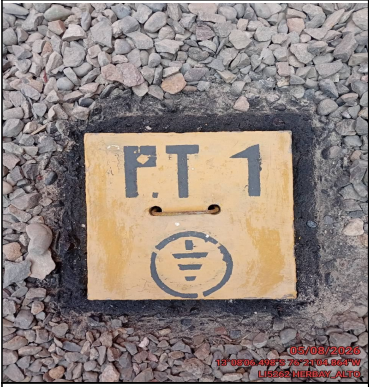
Pozo a tierra
