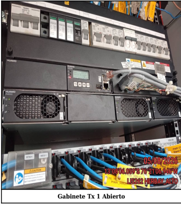
Gabinete Tx 1 Abierto
