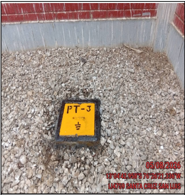
Pozo a tierra
