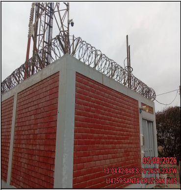
Pozo a tierra
