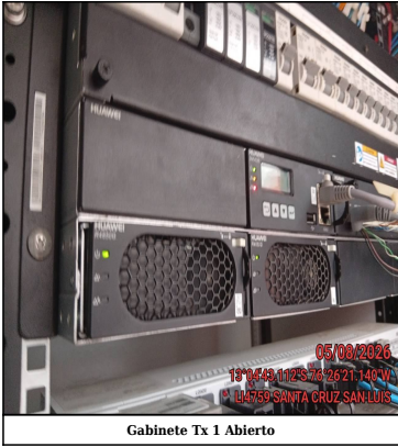
Gabinete Tx 1 Abierto
