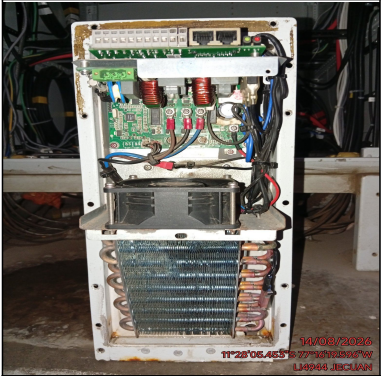
AREA DE UNIDAD EVAPORADORA
