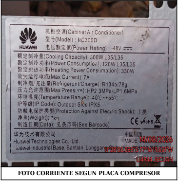
FOTO CORRIENTE SEGUN PLACA COMPRESOR
