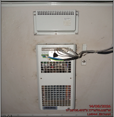
FOTO PANORAMICA DE EQUIPOS
