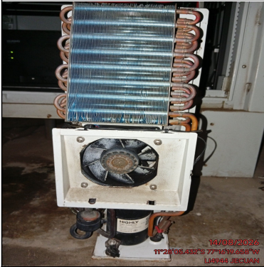
AREA DE UNIDAD CONDENSADORA
