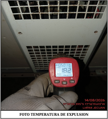
FOTO TEMPERATURA DE EXPULSION
