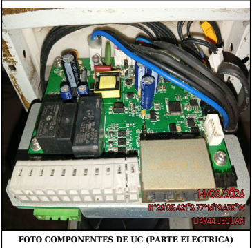
FOTO COMPONENTES DE UC (PARTE ELECTRICA)
