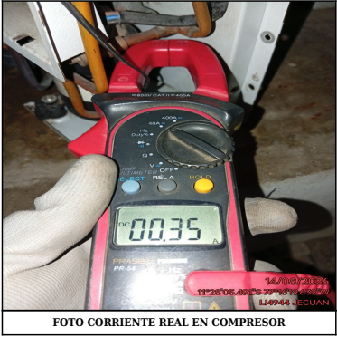
FOTO CORRIENTE REAL EN COMPRESOR
