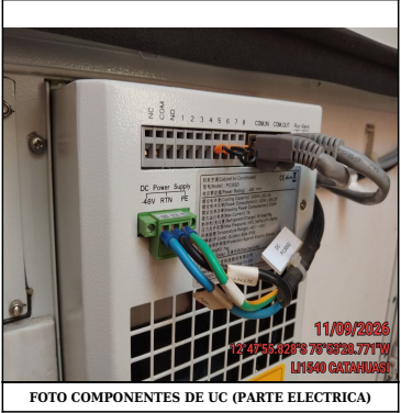
FOTO COMPONENTES DE UC (PARTE ELECTRICA)
