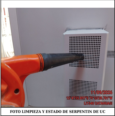
FOTO LIMPIEZA Y ESTADO DE SERPENTIN DE UC
