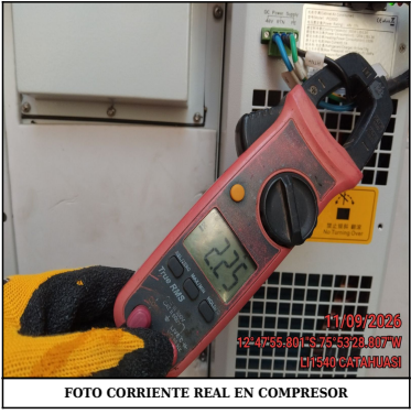
FOTO CORRIENTE REAL EN COMPRESOR
