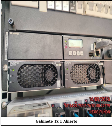
Gabinete Tx 1 Abierto
