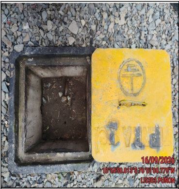
Pozo a tierra
