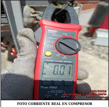
FOTO CORRIENTE REAL EN COMPRESOR
