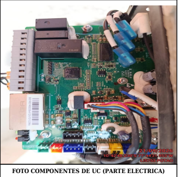
FOTO COMPONENTES DE UC (PARTE ELECTRICA)
