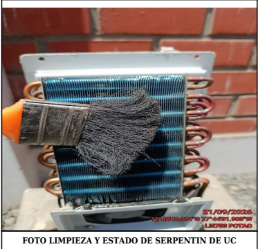
FOTO LIMPIEZA Y ESTADO DE SERPENTIN DE UC
