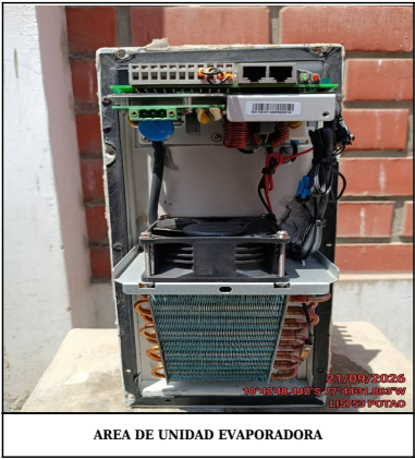
AREA DE UNIDAD EVAPORADORA
