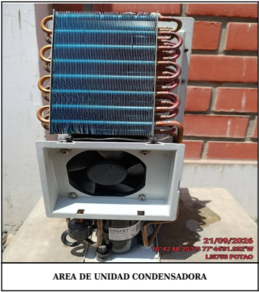
AREA DE UNIDAD CONDENSADORA
